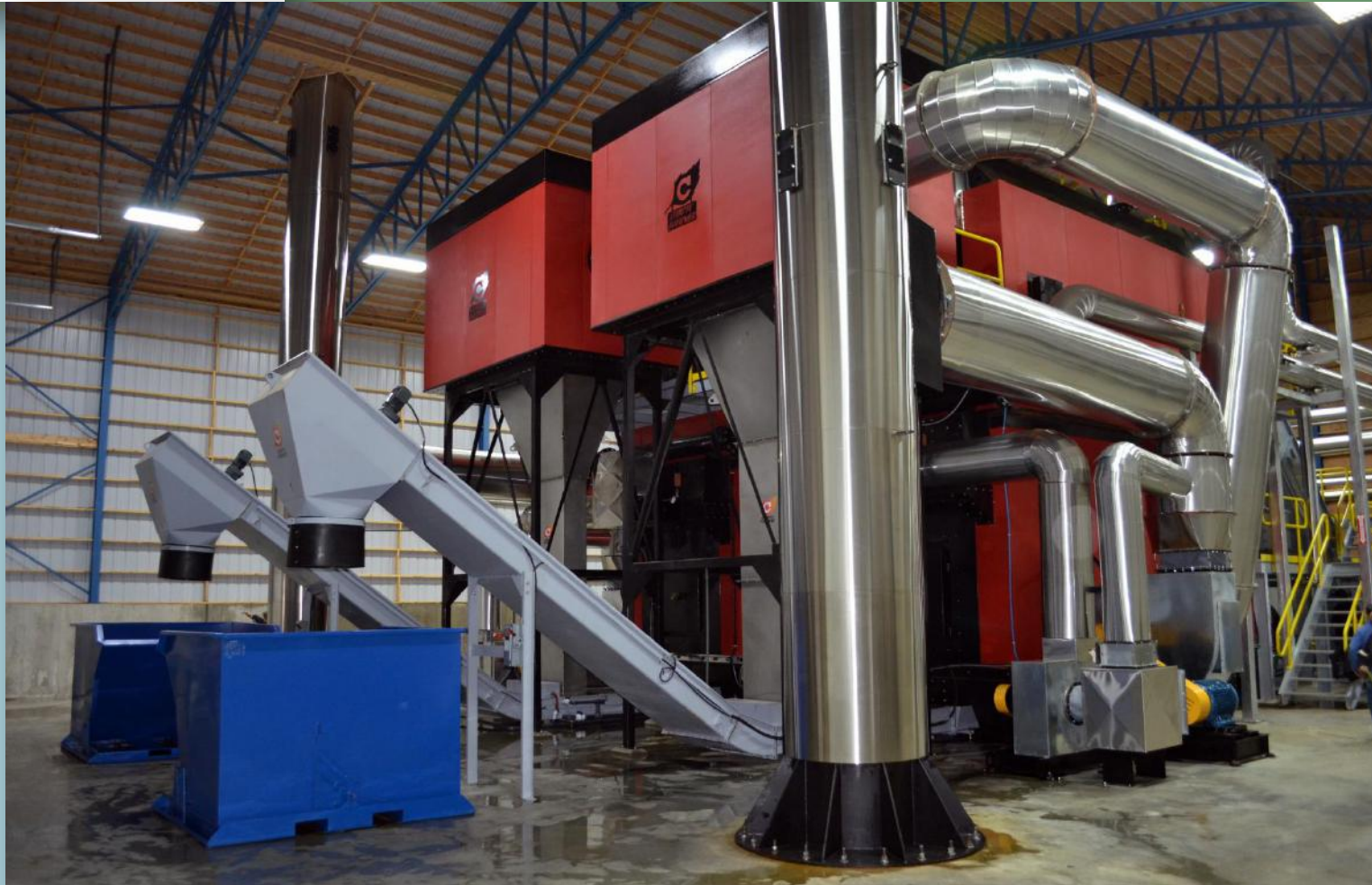
Projet de conversion à la biomasse aux Serres Lefort , 2011 (2x 6000 kW) Réalisation : Jean Gobeil & Associés Inc.
