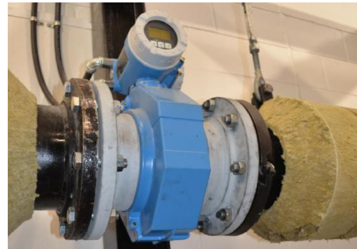
(Serres Demers 2012, St-Nicéphore, Compteur énergétique)
